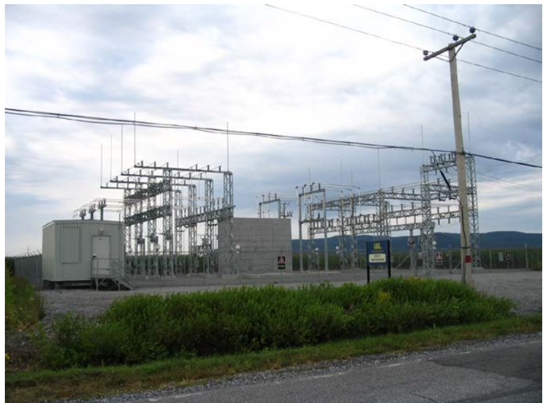
Le poste électrique de la Coopérative régionale d'électricité de Saint-Jean-Baptiste-de-Rouville à Saint-Damase
